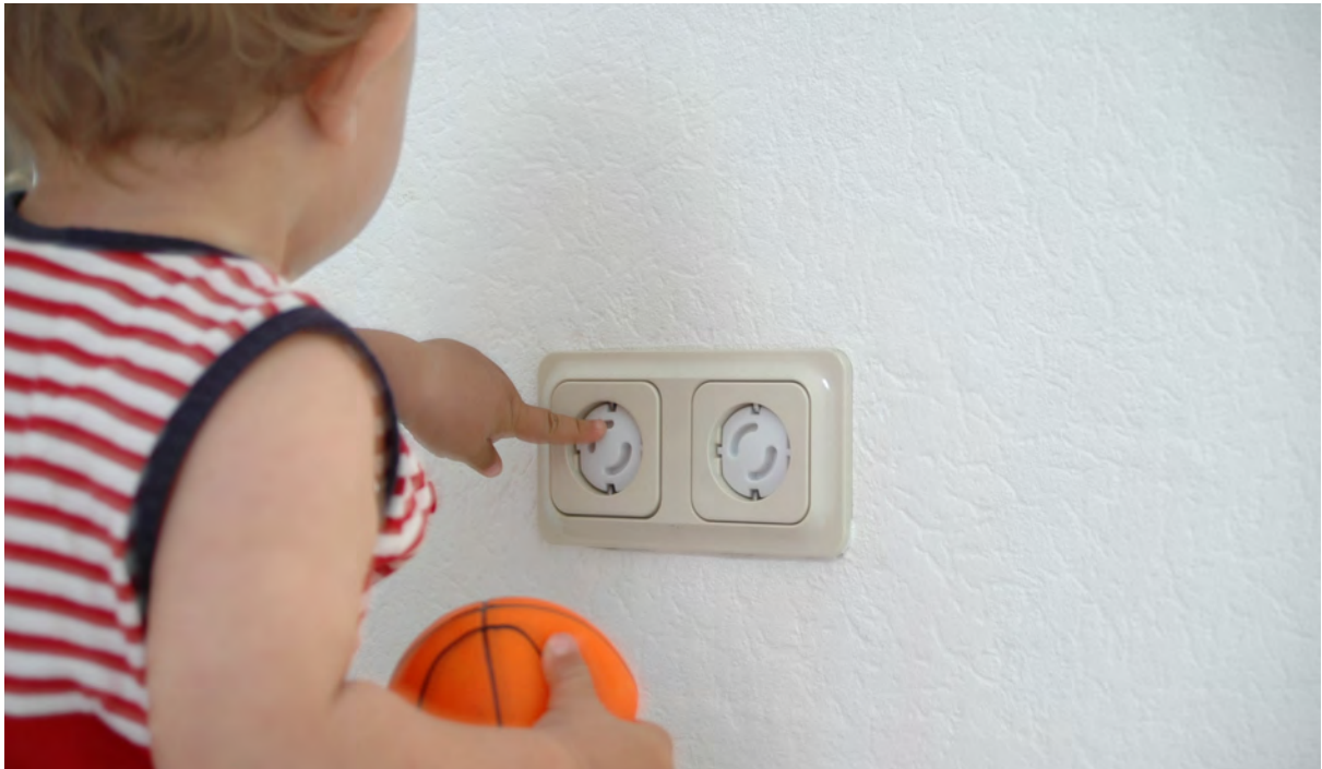
Abb. 4: Kindersicherung in Steckdosen
